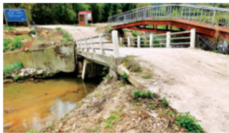
洪水損壞的危橋
